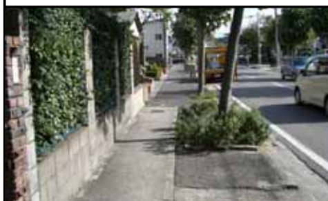
老朽化した路面の状態
