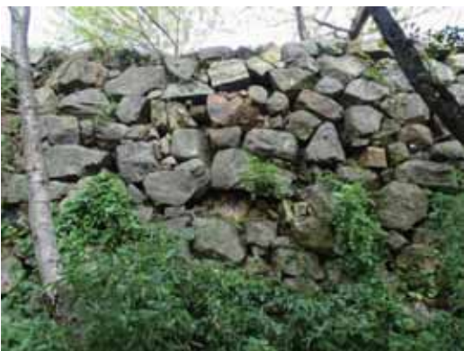
石材の欠落、孕み出し
