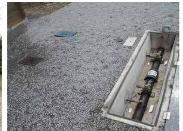
水道管展示スペース
