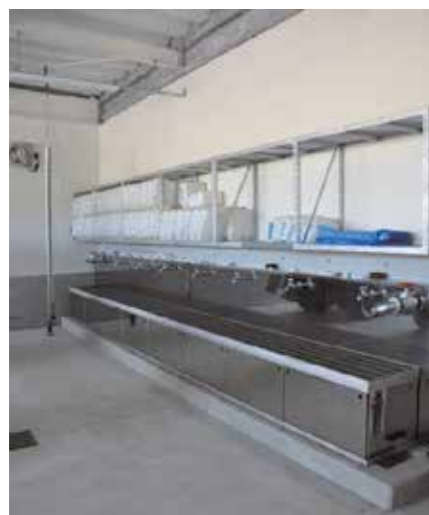
米子市水道局庁舎応急給水用給水栓
