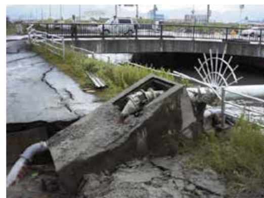
水管橋橋台部の隆起
