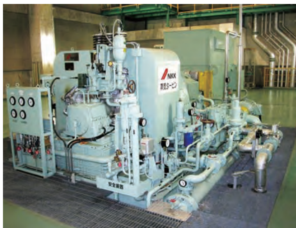
クリーンセンター発電機
