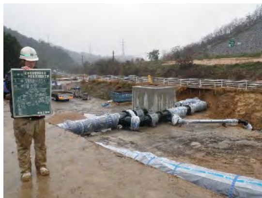
中央配水管流量調整弁 φ 800
