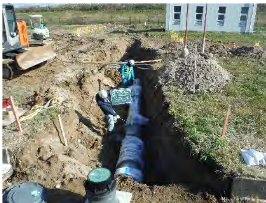
南部送配水管分岐（戸上管理棟東側）
