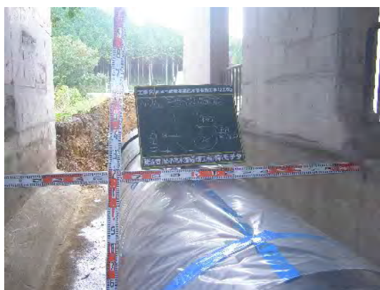
中央配水管（9号バイパストンネル内）
