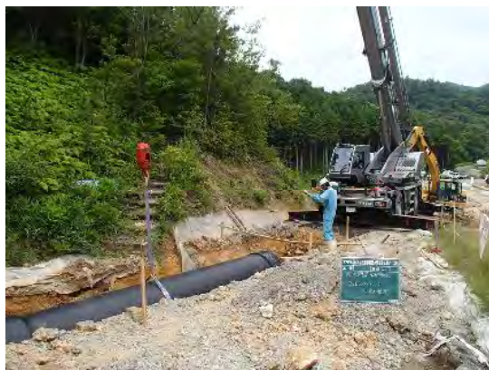
中央配水管（管理道路）φ 1000
