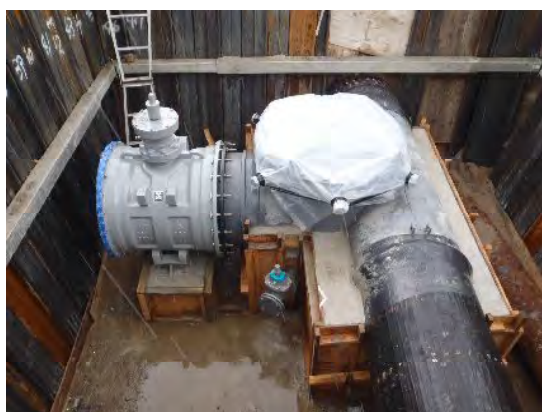
中央配水管分岐（局駐車場）
