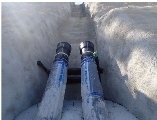
南部送配水管（法面配管）
