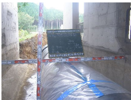
中央配水管（9号バイパストンネル内）
