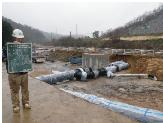
中央配水管流量調整弁 φ 800
