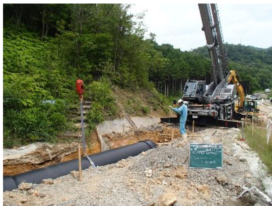
中央配水管（管理道路）φ 1000
