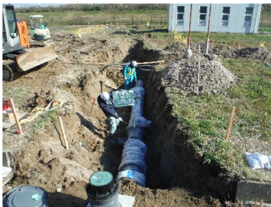
南部送配水管分岐（戸上管理棟東側）
