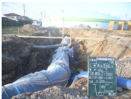
中央配水管（車尾水源地内）
