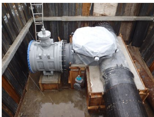
中央配水管分岐（局駐車場）
