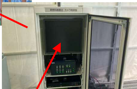
カメラ制御盤
