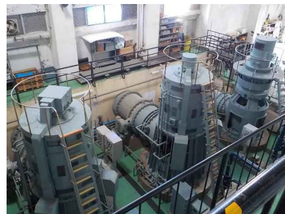
米子市中央ポンプ場
