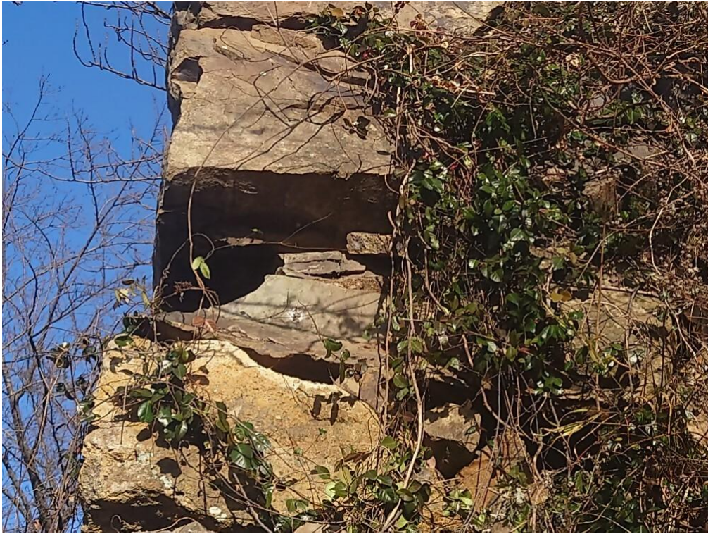
石材剥落部分
