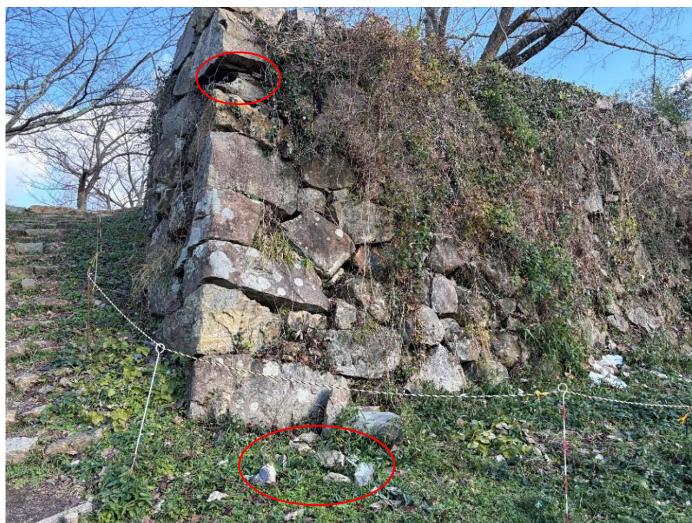
剥落した石材
