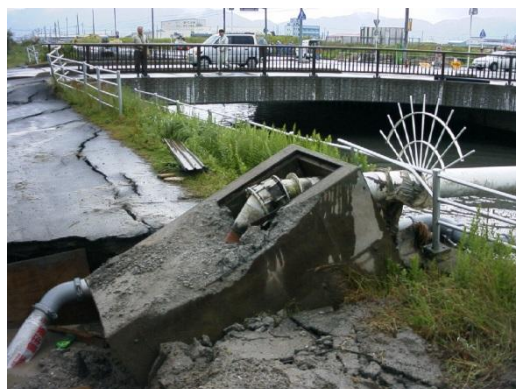
水管橋橋台部の隆起
