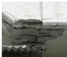
CO剥離・鉄筋むき出し
