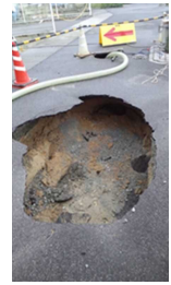
管の破損による道路陥没
