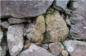
築石部中部に割れを確認
