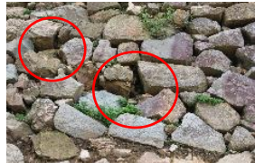
中部に抜け落ちを確認
