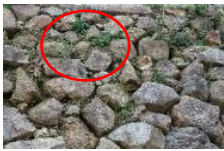
中部に抜け落ちを確認
