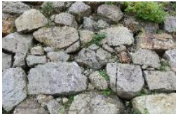
中部に多数の割れを確認
