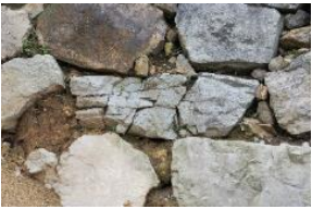
中部に割れを確認
