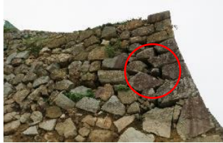
右側中部に抜け落ちを確認
