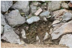
右側中部に抜け落ちを確認
