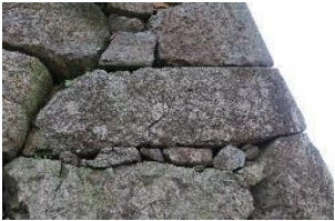
中部に割れを確認
