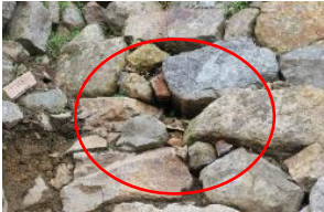
中部に抜け落ちを確認
