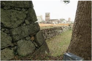
右側隅角部付近に樹木(クスノキ)が巨木化している
