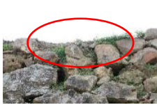
天端に抜け落ちを確認
