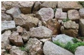
中部に割れを確認
