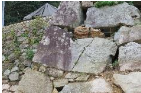
左側中部に割れを確認
