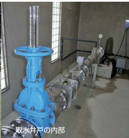
さまざまな水道管が張り巡らされている
