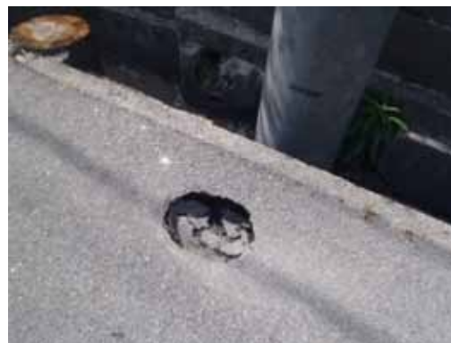
道路の陥没（穴）
