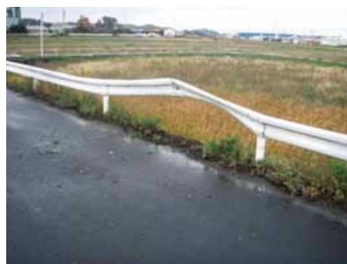
ガードレールの損傷
