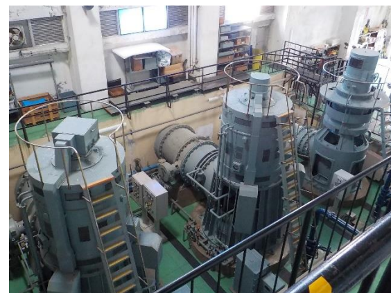
米子市中央ポンプ場
