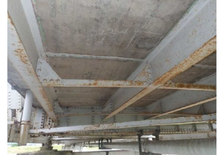
防食機能の劣化
