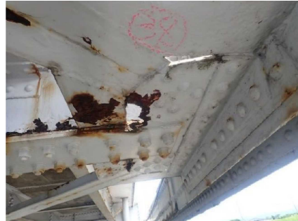
孔食を伴う腐食
