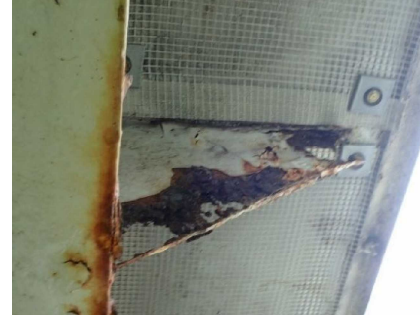
補鋼材の腐食・欠損
