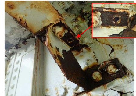
腐食・ボルトの欠損
