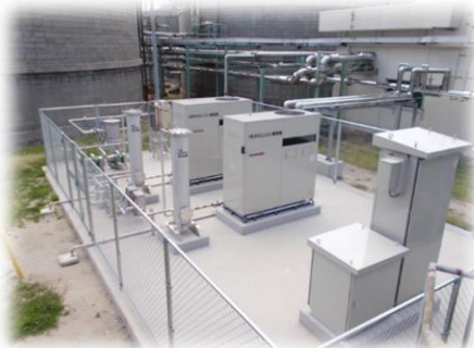
「米子未利用エネルギー活動事業」 消化ガス発電機の 整備・運用
