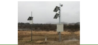
左:危機管理型水位計 右:河川監視カメラ
