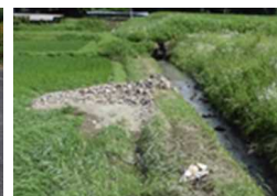
【災害による水路閉塞】
