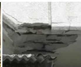
CO剥離・鉄筋むき出し
