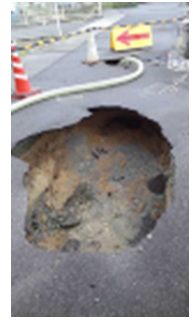
管の破損による道路陥没
