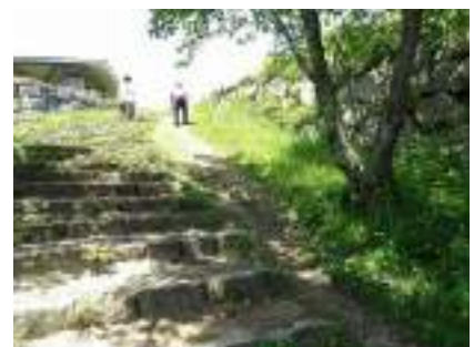
石段際の土壌の流出（鉄門付近）
