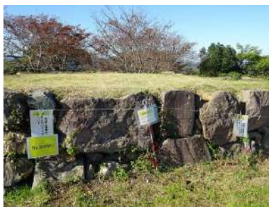
石垣保護のために緊急的に設置した立ち入り制限の表示
