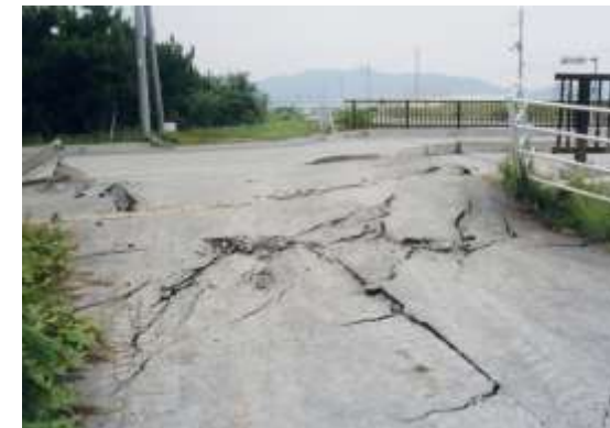
鳥取県西部地震の状況
