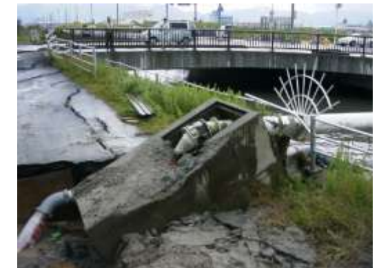
水管橋橋台部の隆起
