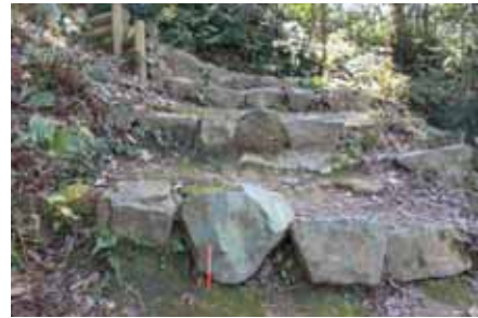
園路の階段の現況
