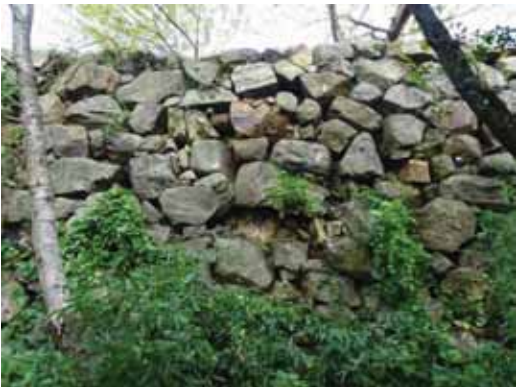
石材の欠落、孕み出し
