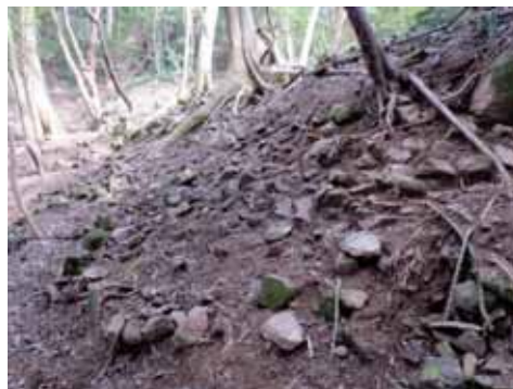
崩落し、栗石の露出した石垣 (水手御門下郭)
