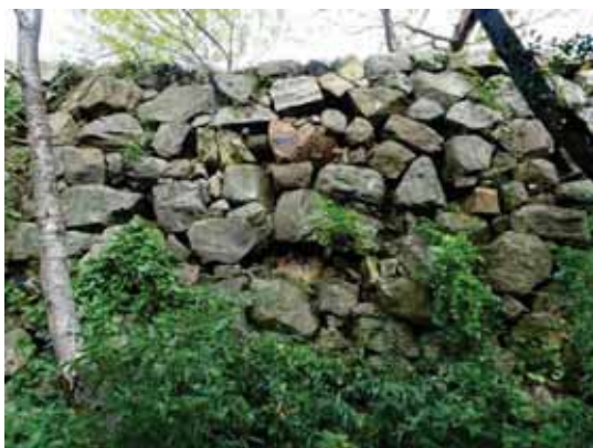
石材の欠落、孕み出し
