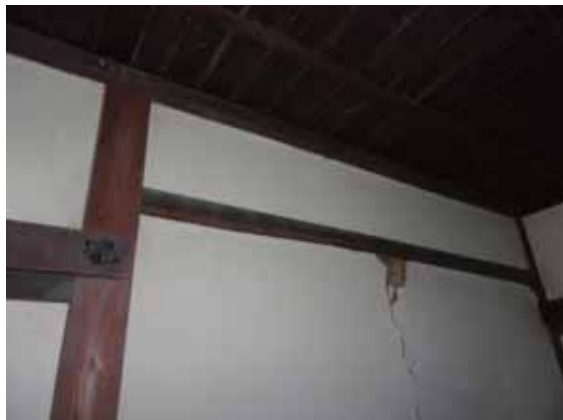
漆喰壁のひび割れと剥がれ状況
