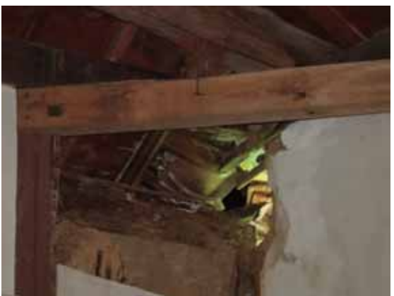
屋内よりみる南隅の破損状況
