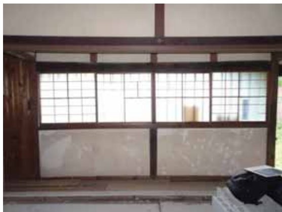
下部漆喰塗壁の汚損状況
