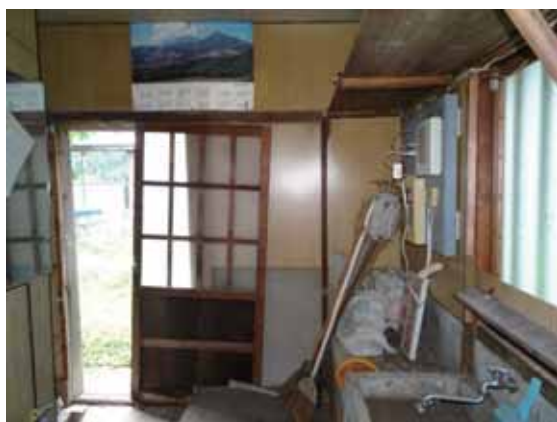
建具の破損状況（北室出入口の引き戸）
