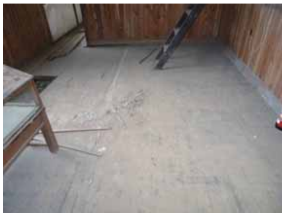
床板の破損状況
