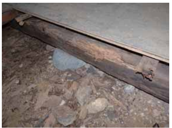
転ばし根太（大引）の腐朽状況
