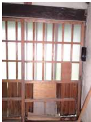
建具の破損状況（南室出入口の引き戸）
