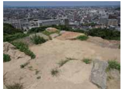
土系硬化舗装の破損部（天守） ・欠損部の表土が固結し雨水排水に支障をきたしている。
