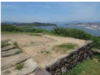
遺構保護土の流出（天守）
