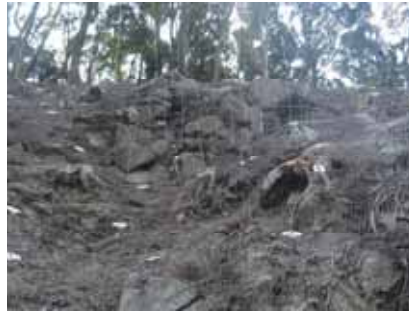
補強材(ロックボルト)と、高強度 ネットによる斜面補強 (史跡新宮城跡 平成 23 年)
