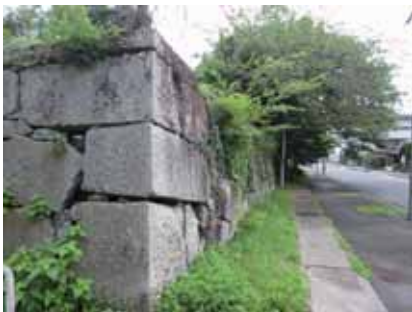
桁形石垣の孕み出し
