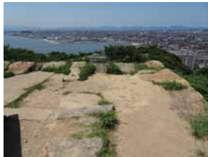
土系硬化舗装の破損部（天守） ・破損部の表土が固結しすべりやすくなっている。
