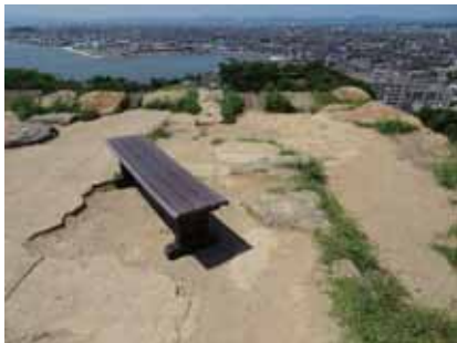
土系硬化舗装の破損部（天守） ・破損により段差が生じている。
