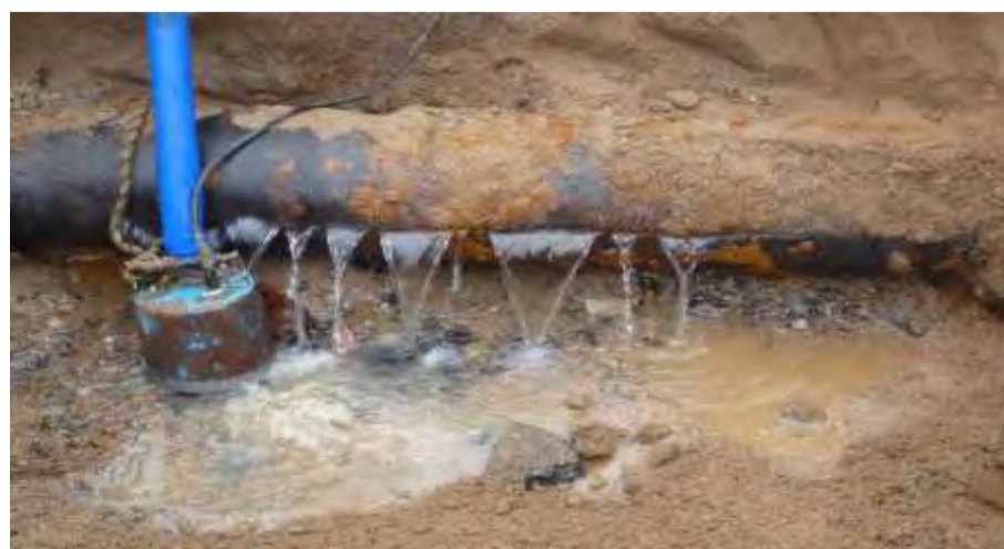
▲米子市内管破損の様子
