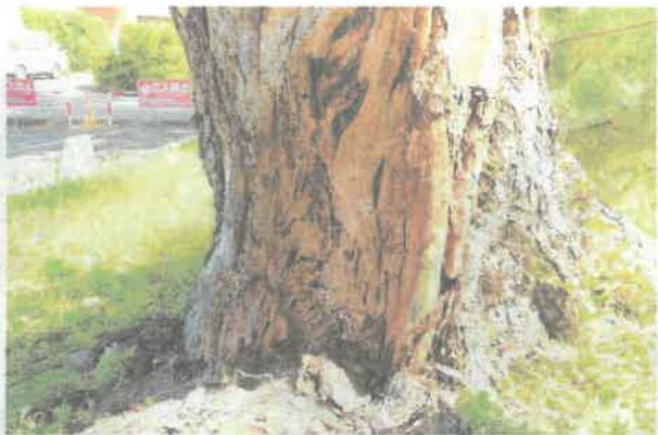
写真7 根元北側の腐朽部
