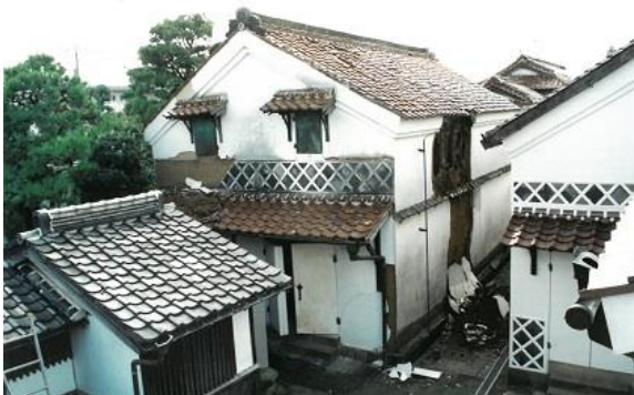
鳥取県西部地震被害(重要文化財後藤家住宅)
