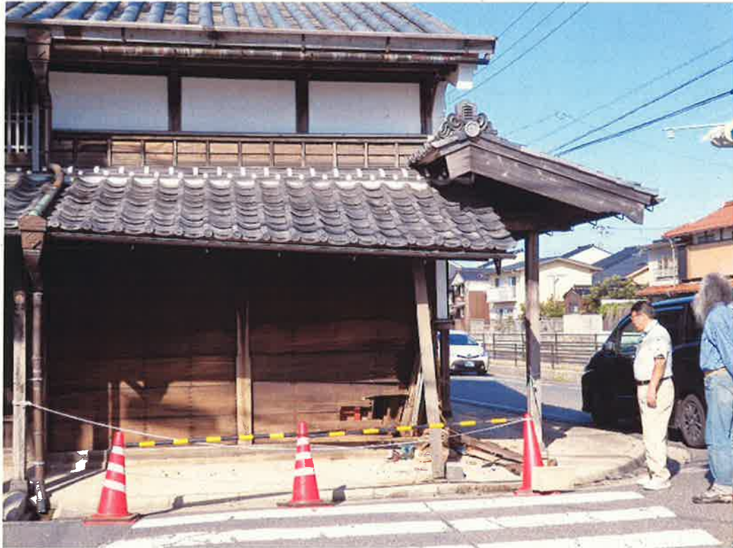
写真5 後藤家住宅自動車事故毀損の様子
