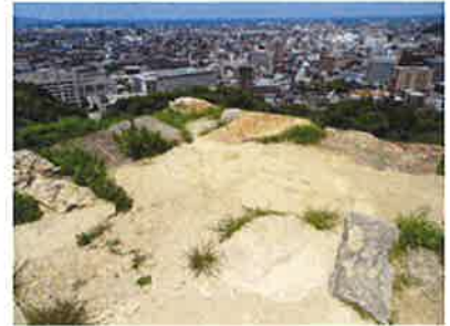
土系硬化舗装の破損部 ・欠損部の土壌が固結し雨水排水に支障をきたしている。
