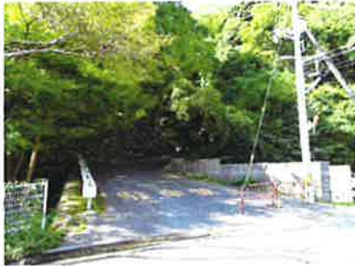
二の丸虎口が植栽と構造物により認識できない
