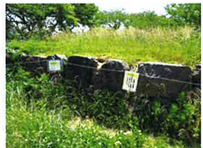
石垣天端に登るため、石垣背面がえぐれている
