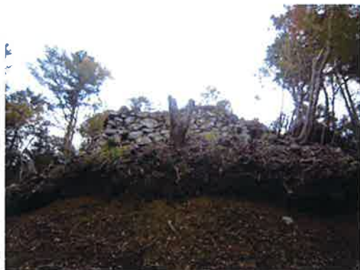
石垣裾の基盤のオーバーハング (史跡有子山城跡)
