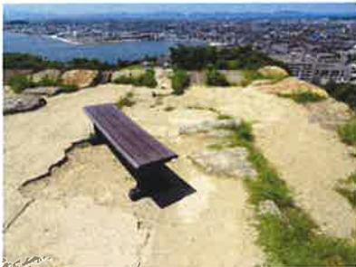
土系硬化舗装の破損部 ・破損部に段差が生じている。
