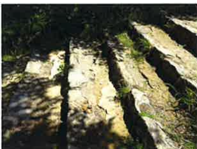
階段石の欠落と土系硬化舗装の破損
