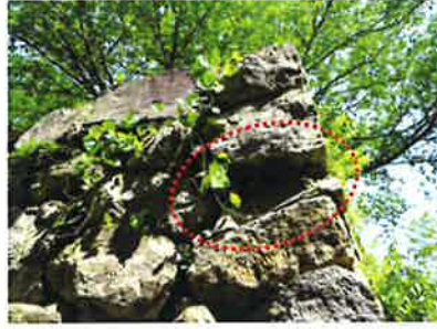
同左：角石の一部欠落。
