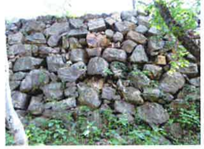
同左：築石の割れ。
