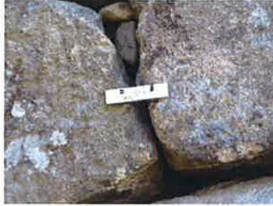
クラックゲージの設置 (史跡小峰城跡)
