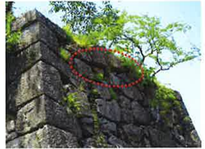
同左：天端石のせり出し。
