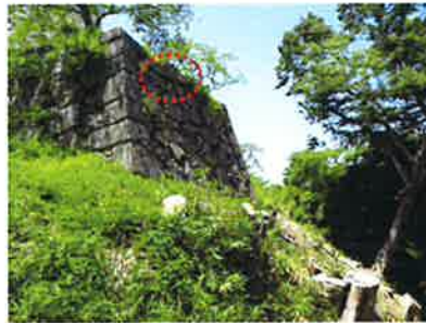
同左：天端石のせり出し。
