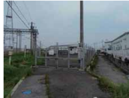
二本木水源地 第 3 号取水井の外観
