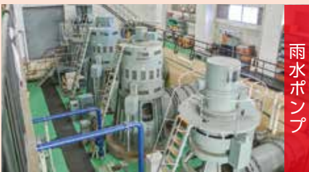
▲市街地を豪雨から守る雨水ポンプ
