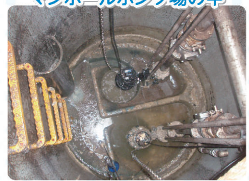
マンホールポンプ場の中
