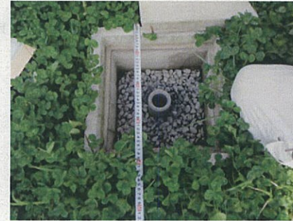
パナソニック観測孔（北側） の外観
